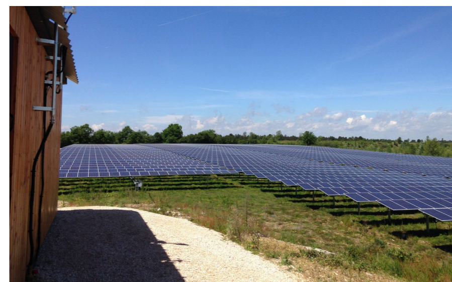
Centrale de Bessens (82) en exploitation (crédit photo : Urbasolar)
