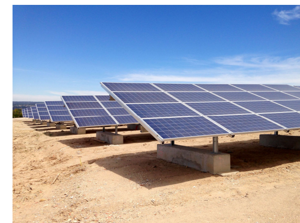
Centrale de Gardanne (13) en exploitation (crédit photo : Urbasolar)
